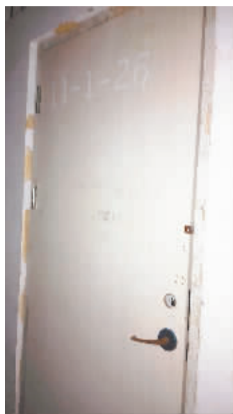
杨先生家地下室门锁被破坏,露出圆形窟窿,整个门框摇摇欲坠。
